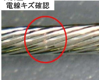
電線キズ確認
